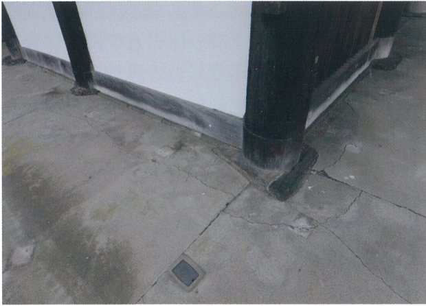
土間の割れ・礎石の沈下・割れ
