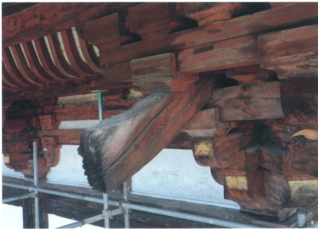
組物の割れ（初重尾垂木）
