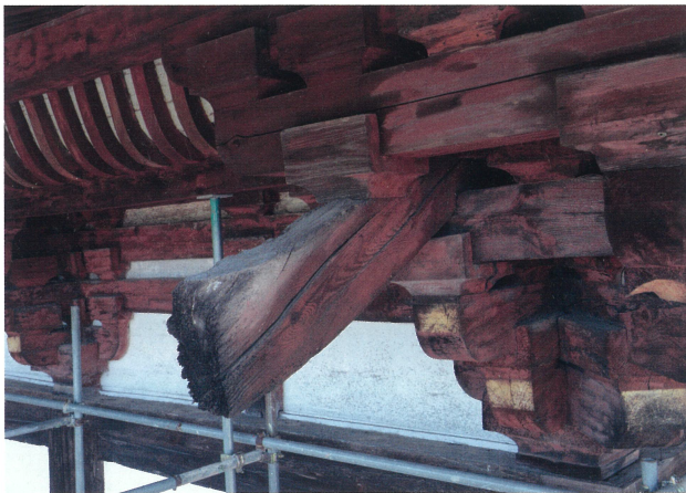
組物の割れ（初重尾垂木）
