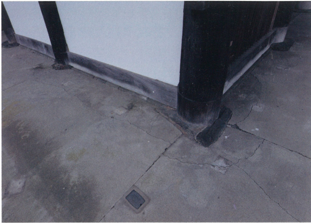
土間の割れ・礎石の沈下・割れ
