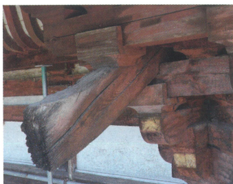
▲亀裂が生じた部材 (初重 尾垂木)
